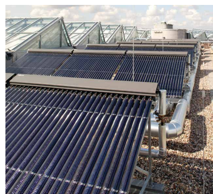
Die Solaranlage des Umweltbundesamtes in Dessau: 345 Quadratmeter Vakuum-Röhrenkollektoren liefern die Antriebsenergie für eine Adsorptionskältemaschine und unterstützen die Raumbeheizung.
