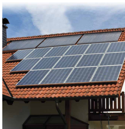
Hausdach mit Photovoltaikmodulen und einer solarthermischen Anlage mit Vakuum-Röhrenkollektoren.
