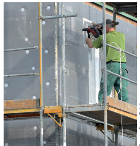
In der Praxis hat es sich gezeigt, dass Bauherren die „Besser-als-die-EnEV-Option“ bei der Dämmung gerne wahrnehmen. Damit lässt sich der Einsatz erneuerbarer Energie bei der Heizung, Kühlung und Warmwassererzeugung umgehen.
