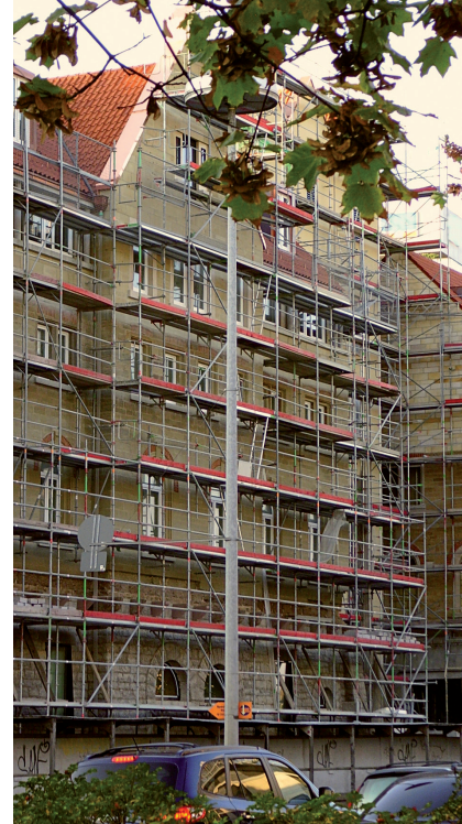
Wer über ein Zehntel der Außenwandfläche seines Altbaus zusätzlich dämmt, muss die Wärmeschutzanforderungen der EnEV beachten.
